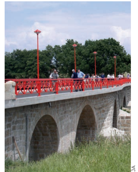
Detritos preocupam junto à Ponte Pedrinha
