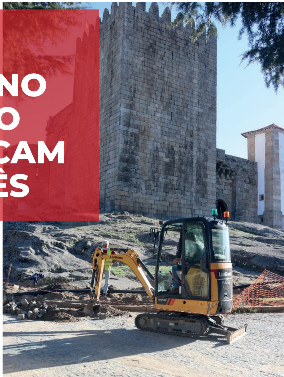
Obras, estimadas em cerca de 150 mil euros, visam acabar com alguns problemas na Torre, nomeadamente infiltrações
